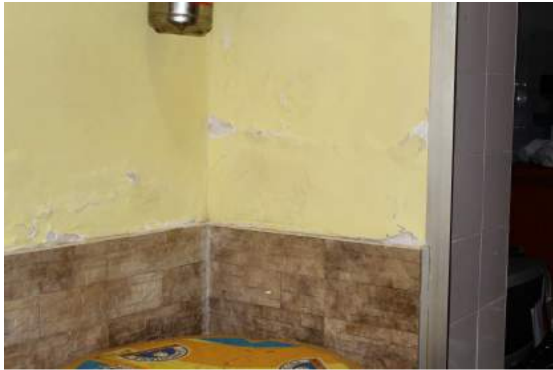
Foto n°16: Ammaloramento su parete in muratura ubicata nel vano 2, a confine con particella aliena (579) e con il vano 3.
