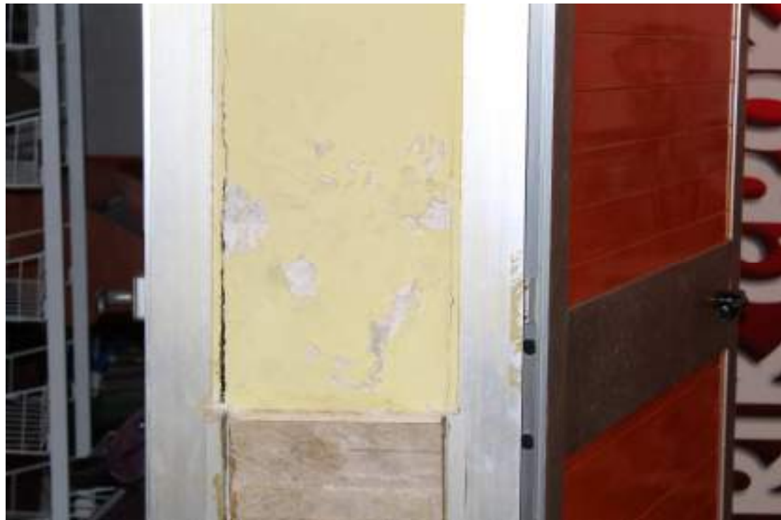
Foto n°17: Ammaloramento su parete in muratura ubicata nel vano 2, a confine con i vani 3 e 4.
