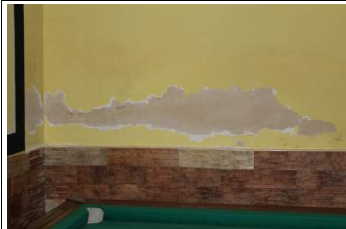
Foto n°19: Ammaloramento su parete in muratura ubicata nel vano 1, a confine con il vano scala condominiale.
