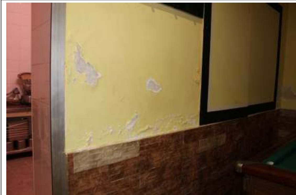
Foto n°18: Ammaloramento su parete in muratura ubicata nel vano 2, a confine con il vano 3.
