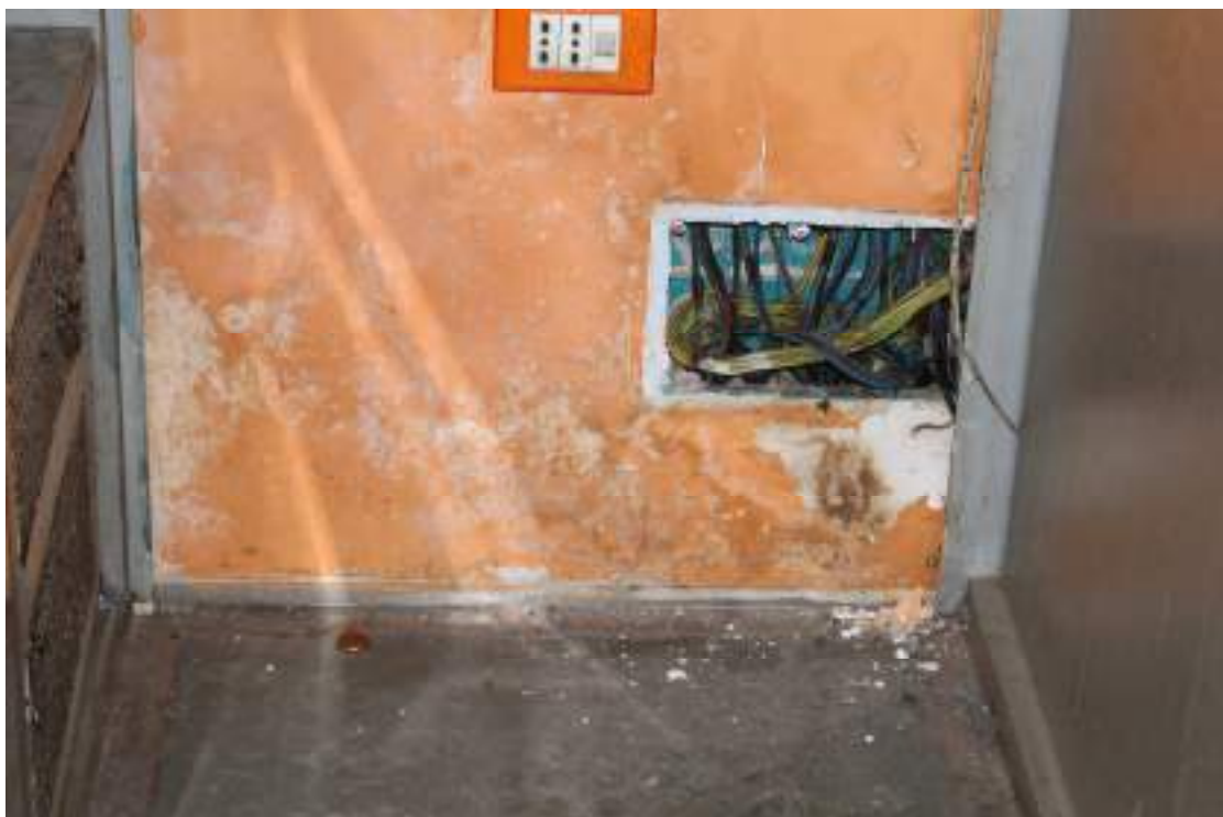
Foto n°21: Ammaloramento su parete in muratura ubicata nel vano 1, a confine con il vano 6 e 6a.
