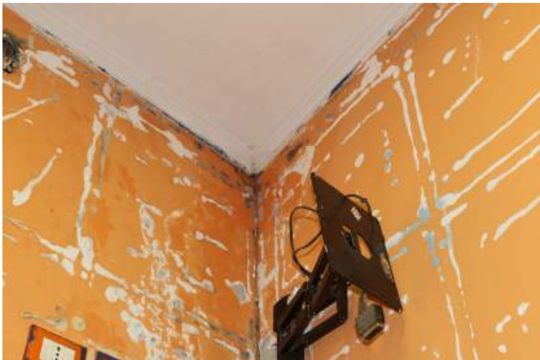
Foto n°20: Ammaloramento su parete in muratura ubicata nel vano 1, a confine con particella aliena (579) e Cortile Chiavelli.
